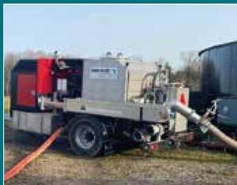
Maschine mit Wassertank und Ausblaskompressor
