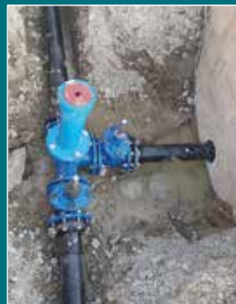
Durchgangshydrant mit Entnahmestelle
